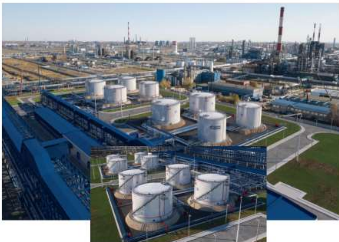
Промежуточные парки УЗК и КГПН АО «Газпромнефть-ОНПЗ»
