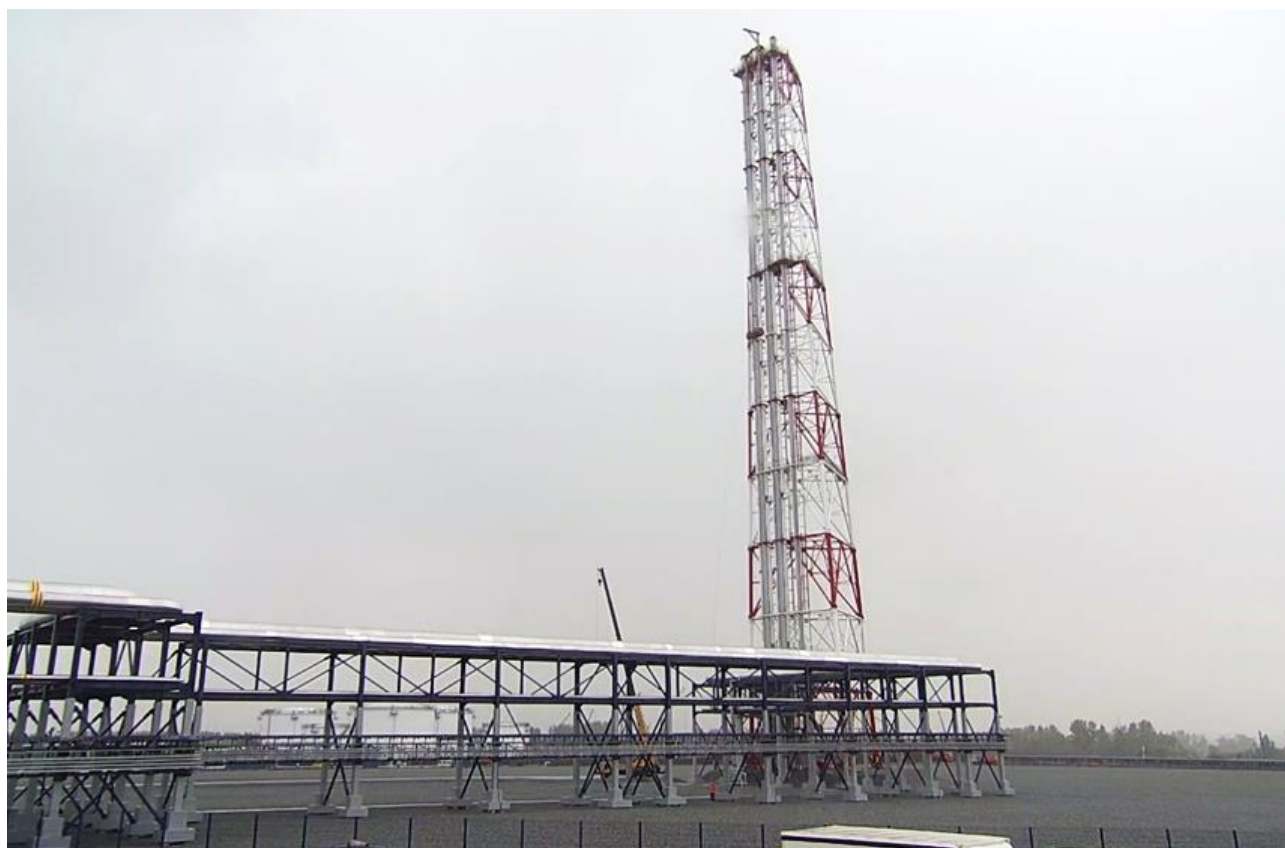
Факельная система ОЗХ комплекса ЭЛОУ-АВТ, УЗК и КГПН АО «Газпромнефть-ОНПЗ»
